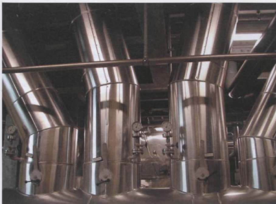
Slibdroger Susteren: luchtcirculatieleidingen.
